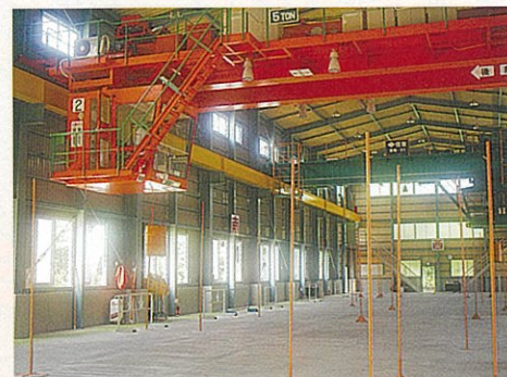
天井式クレーン
